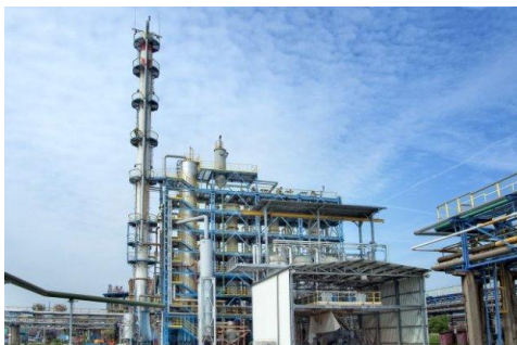
Instalacja tlenku propylenu
